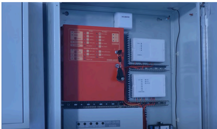
Система охранно-пожарной сигнализации выполнена на основе комплектующих "Болид". В комплектацию станции входит автоматическая установка аэрозольного пожаротушения, включающая генераторы огнетушащего аэрозоля
