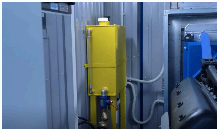
Каждая генераторная установка оснащена системой автоматической дозированной подкачки масла с дополнительным баком 50 литров
